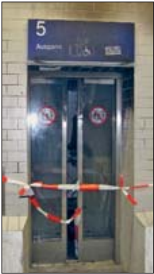
Im Oktober/November 2010 war der reparierte Fahrstuhl am S-Bahnhof Griebnitzsee übergeben worden. Zehn Tage nach der Inbetriebnahme zündeten Jugendliche einen 2-Meter-großen Teddybären im Fahrstuhl an. Die Zerstörungen sind erheblich.
